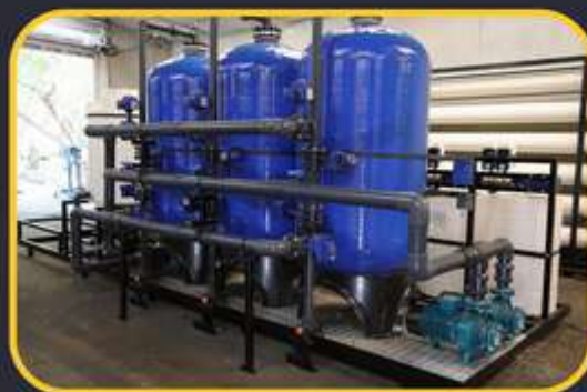
پمپ بشقابی 1+1 به همراه شیرهاب برقی اکشیتور دار دستگاه 16 متر در ساعت فولاد میانه
